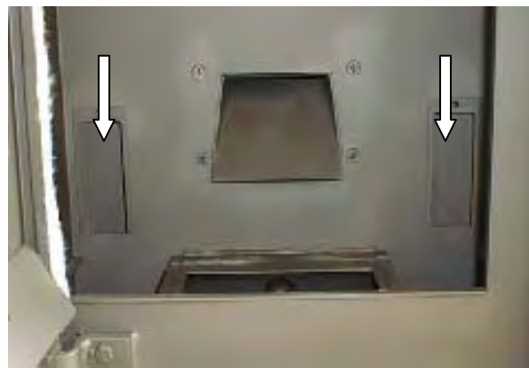
Abb. 19: Untere Reinigungsöffnung Abgaszüge
