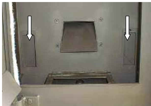
Abb. 17: Untere Reinigungsöffnung Abgaszüge
